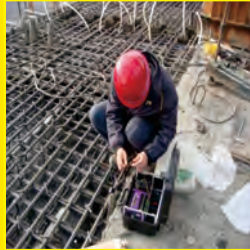
陕西五里坡特大桥监测
